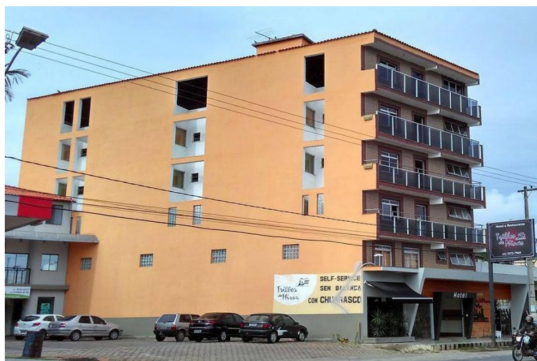
Figura 5 – Uso do afastamento lateral para propiciar ventilação e iluminação natural. Detalhe para a cobertura da edificação faz com que a solução se torne ainda mais ineficaz e para as aberturas em tijolo de vidro no afastamento. Foto: dos autores.
